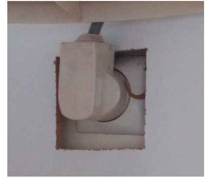
Prise chauffe-eau (PR_CE) / nombre 02
